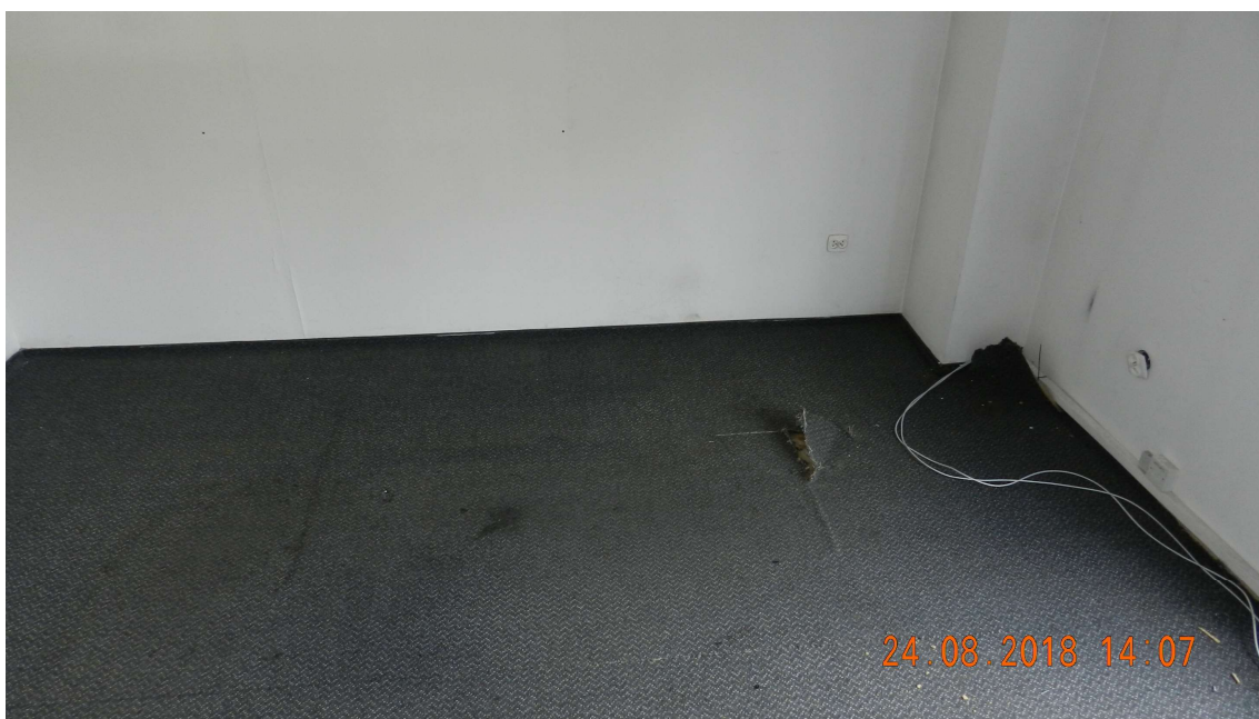
22 Pomieszczenie biurowe, miejsce uszkodzenia podłogi
