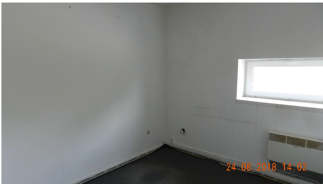
13 Pomieszczenie biurowe, uszkodzone listwy i wykładzina, uszkodzone gniazdko elektryczne
