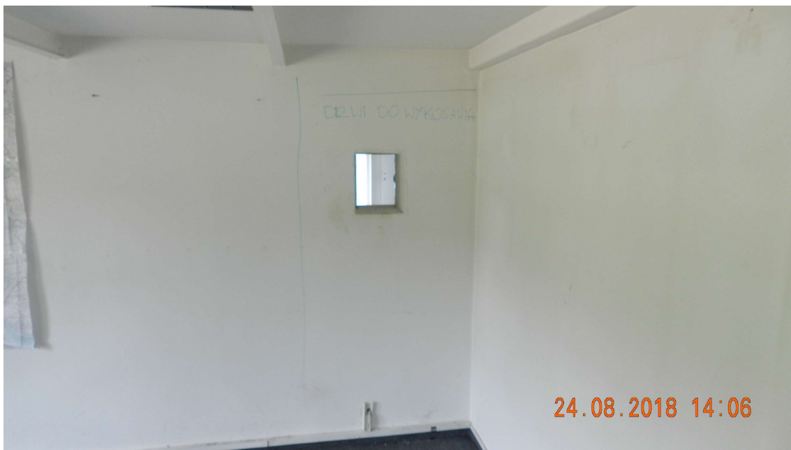
20 Pomieszczenie biurowe, na zdjęciu pokazano miejsce w którym Wykonawca wykona drzwi do pomieszczenia obok
