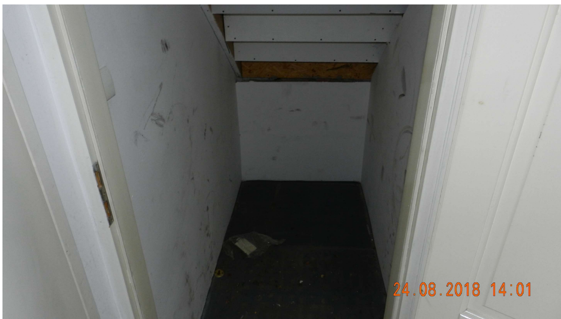
7Pomieszczenie pod schodami na piętro, służące jako schowek, ogólne ślady użytkowania, uszkodzone skrzydło drzwi
