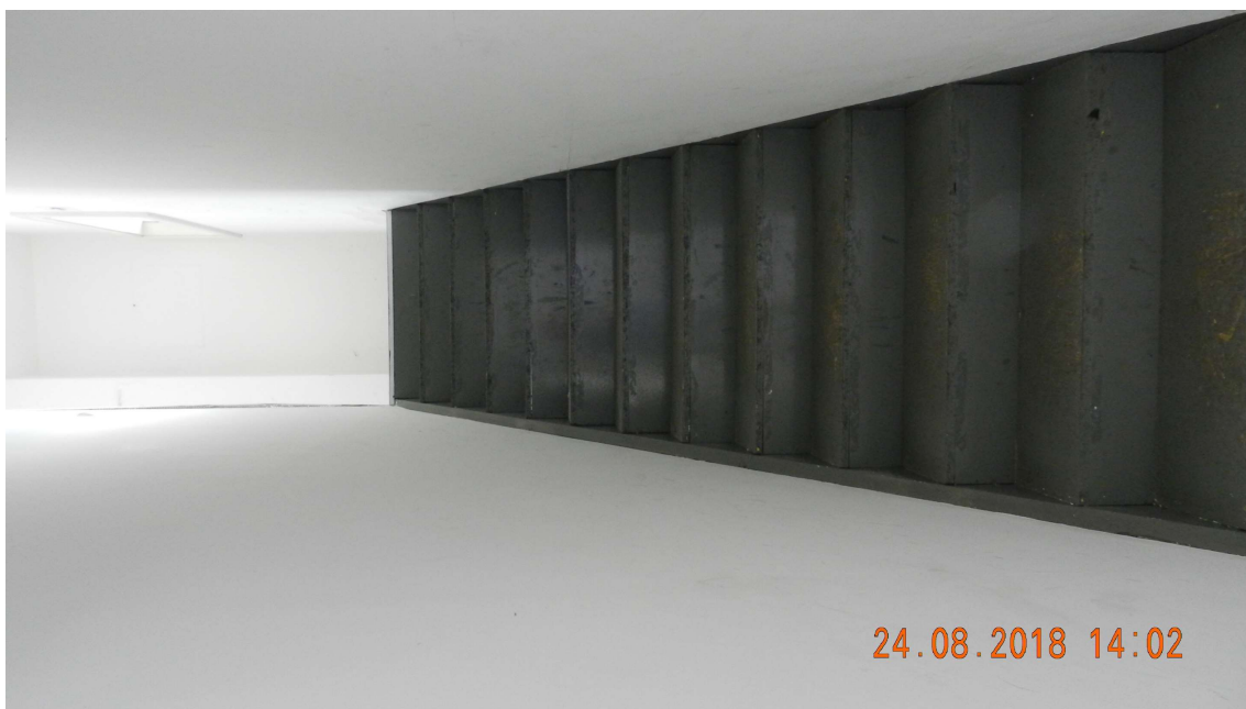
11 Stopnie schodowe, ogólne ślady użytkowania, brak poręczy i nakładek antypoślizgowych
