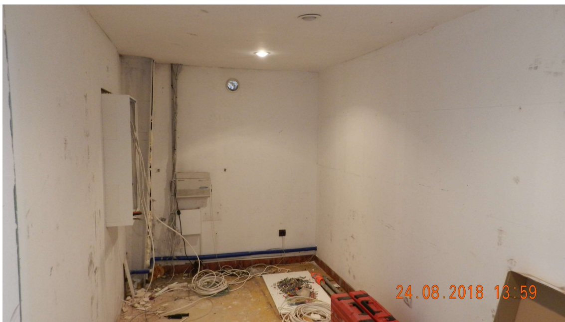
1 Podłoga do odmalowania, listwy przypodłogowe podlegające wymianie, ściany podlegające malowaniu. W tym pomieszczeniu socjalnym sufit znajduje się bezpośrednio pod powierzchnią podłogi która jest uszkodzona, jej lokalizacja zaznaczona jest na schemacie
