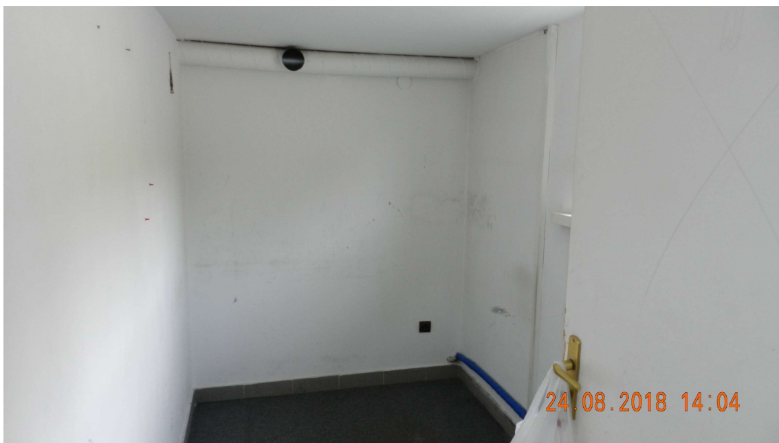
15 Pomieszczenie sojalne, uszkodzone płytki służące jako listwy przypodłogowe, brak zaślepki wentylacyjnej, uszkodzone gniazdo elektryczne, uszkodzone skrzydło drzwi
