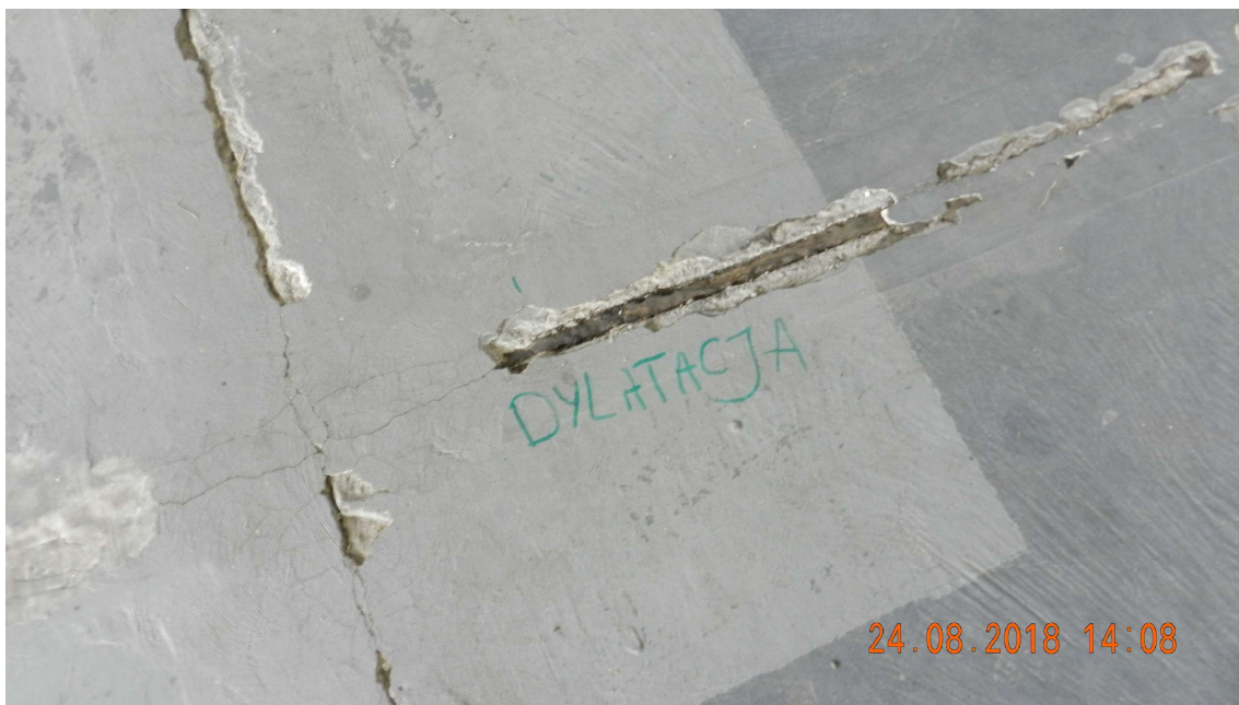
24 Uszkodzona dylatacja - podłoga części hangarowej, pokruszona posadzka
