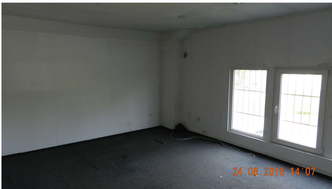
21 Pomieszczenie biurowe, zniszczona wykładzina, uszkodzona (załamana) podłoga
