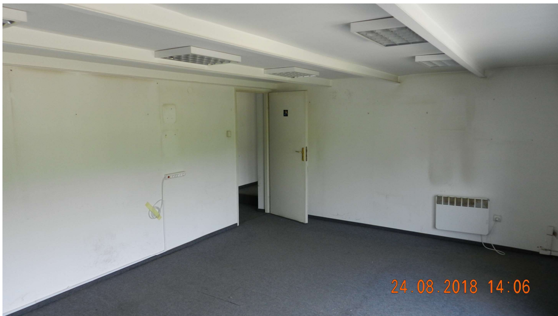
19 Pomieszczenie biurowe, sufit zbyt niski, uszkodzona wykładzina
