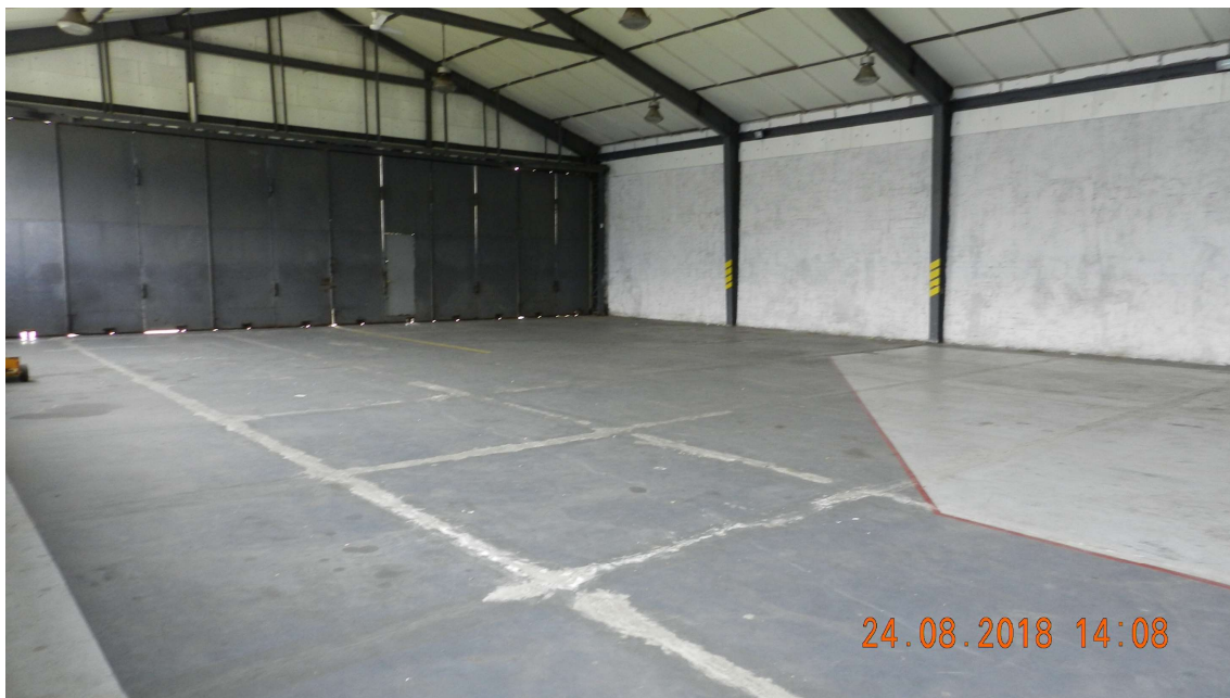
23 Hala hangarowa, ściany noszące ślady użytkowania, popękana dylatacja podłogi
